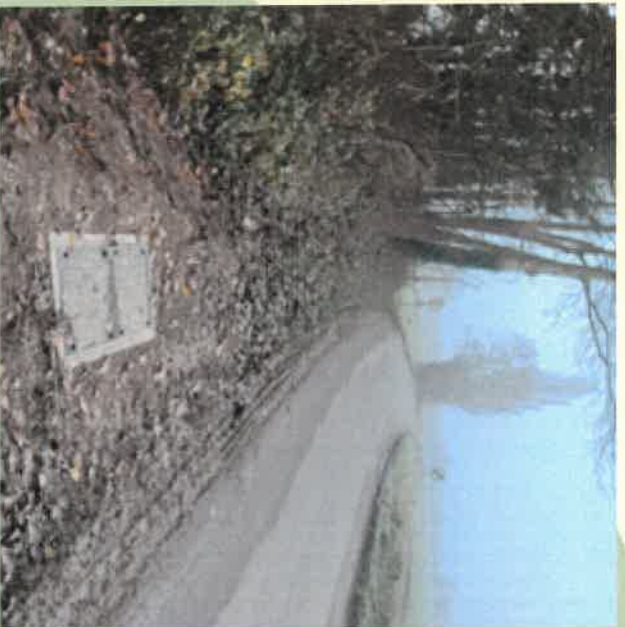
Reprise de la Chambre. Posé par Enedis
